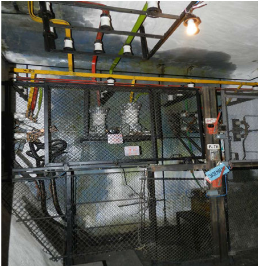
Рисунок 2 – Промасливание перекрытия под маслonaпорной установкой. Пропитка шва монолитного перекрытия и выход масла на стену нижерасположенного помещения
