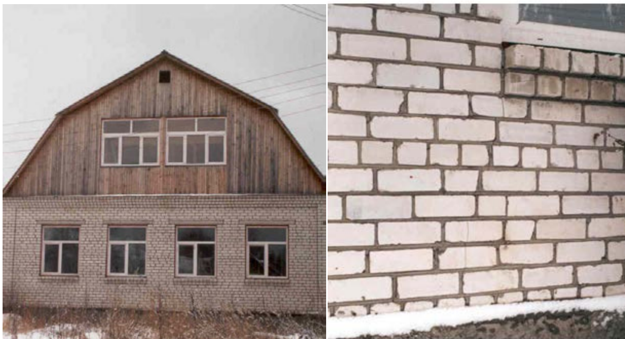
Рисунок 7 – Деформация здания по 1 пер. Локомотивный д.10а
