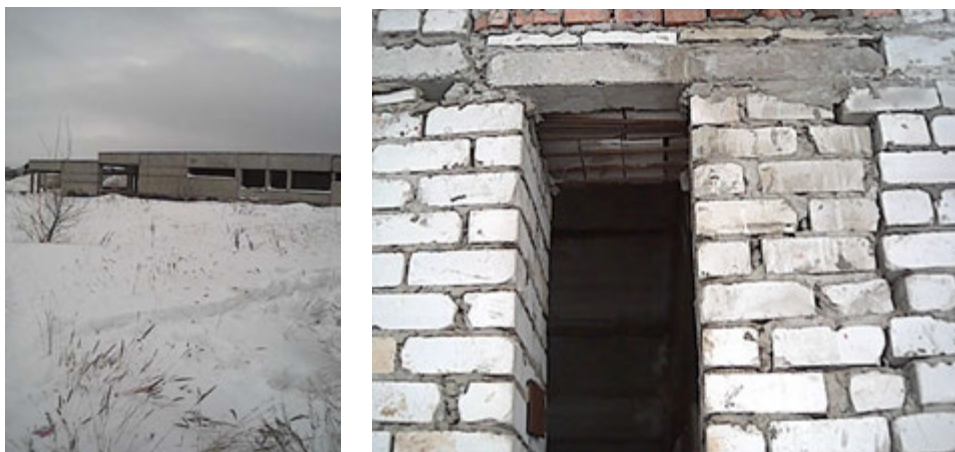
Рисунок 2 – Деформация здания недостроенного рыночного комплекса по пр. Генерала Тюленева, 6А
