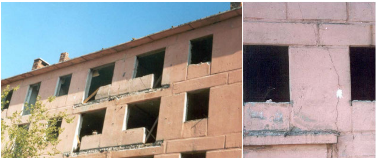
Рисунок 6 – Деформация здания по ул. Азовская 95
