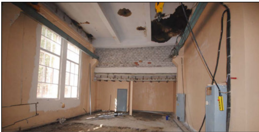
Рисунок 1 – Пятна промасливания на монолитном ребристом перекрытии завода
