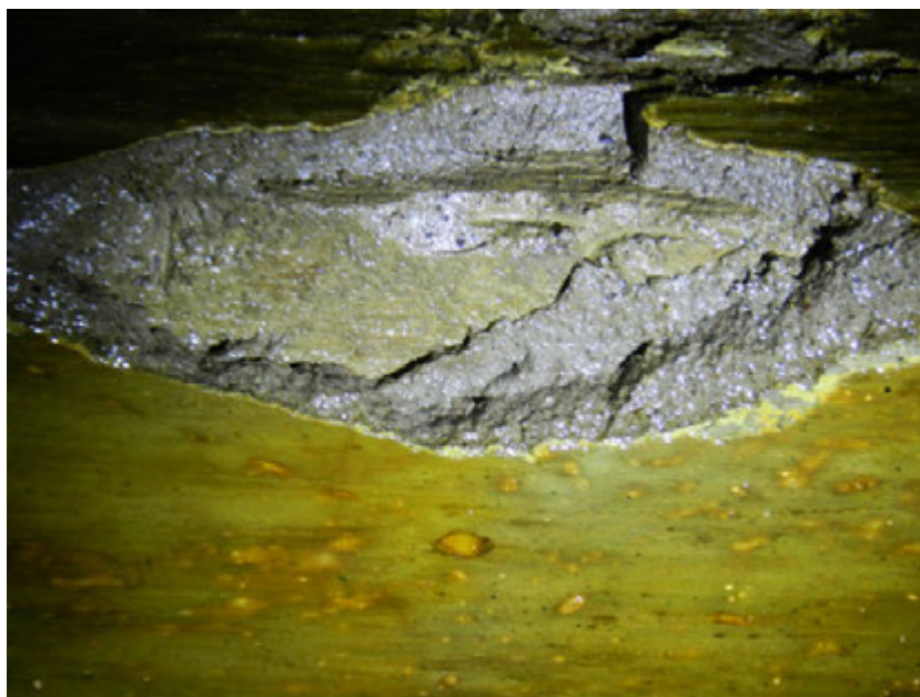
Рисунок 7 – Вскрытие ребра балки промасленного перекрытия на отм. 20,45 м с каплями масла на нижней грани. Наблюдается масло в теле балки
