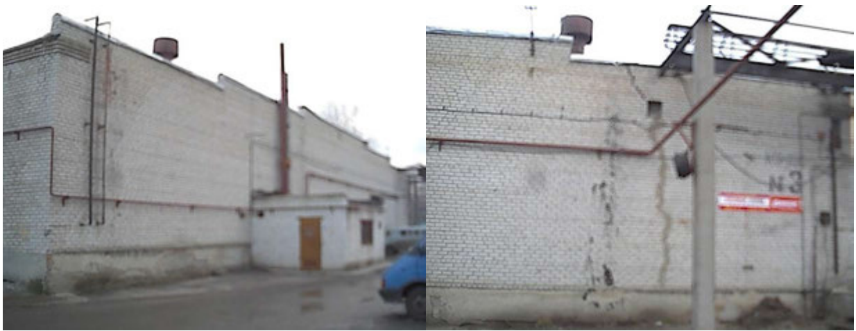
Рисунок 5 – Деформация здания склада по ул. Гая 100
