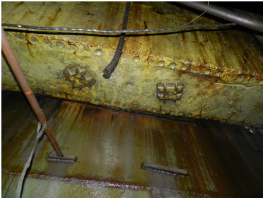
Рисунок 3 – Промасливание боковой и нижней граней и трещин в боковых гранях балки рамного фундамента турбоагрегата
