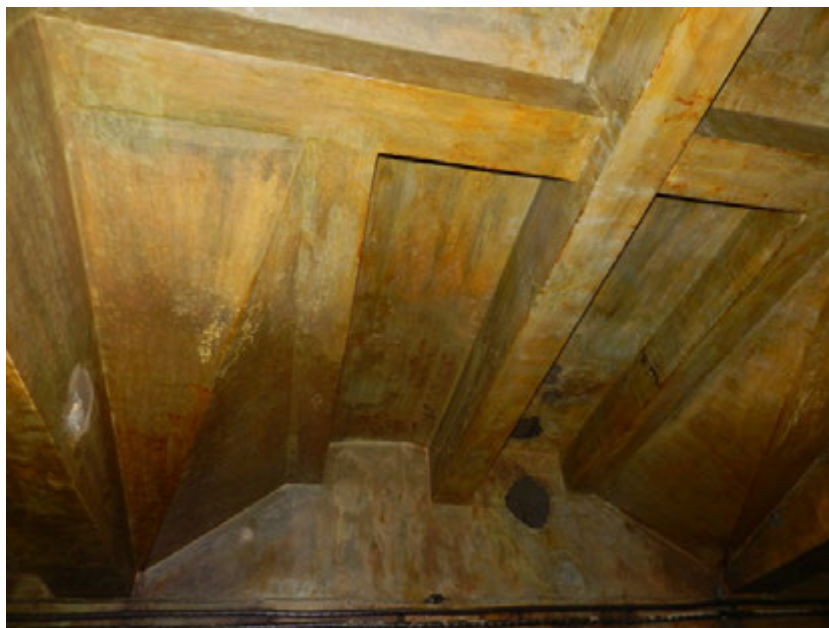
Рисунок 5 – Фрагмент промасленного перекрытия на отм. 20,45 м (под трансформатором)
