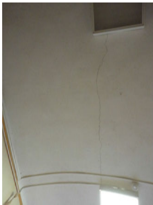
Рисунок 2 – Трещины отделочного слоя распорной конструкции в середине коридора
