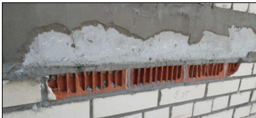
Рисунок 3 – Раздробление кладки под перекрытием
