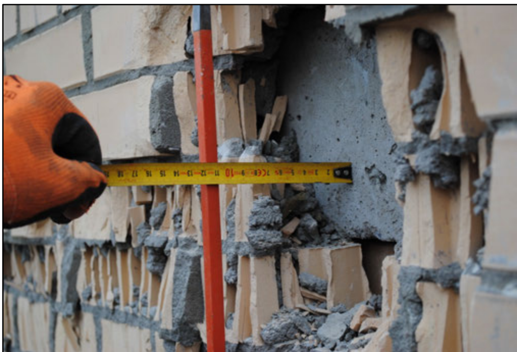
Рисунок 8 – Раздробление кладки в уровне перекрытия
