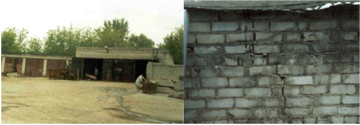
Рисунок 4 – Деформация здания ремонтных боксов по ул. Урицкого 98
