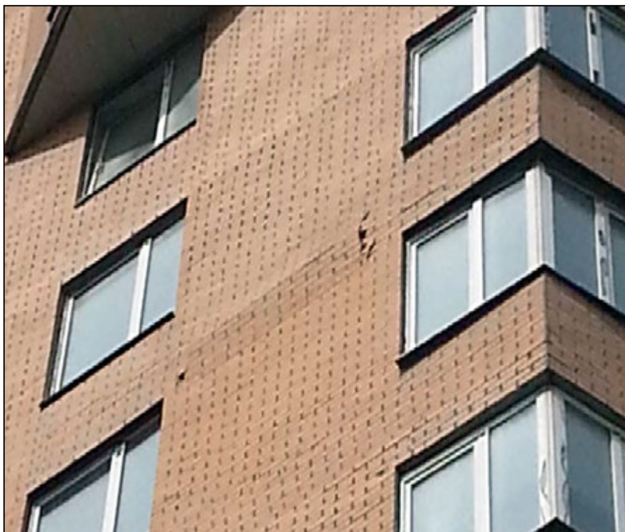
Рисунок 6 – Выпучивание пиленного кирпича в уровне перекрытий
