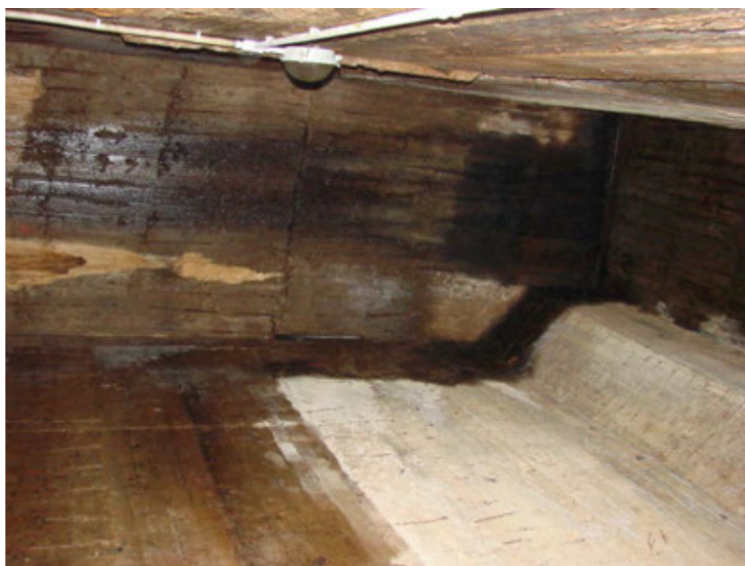
Рисунок 1 – Промасливание перекрытий под трансформаторным помещением
