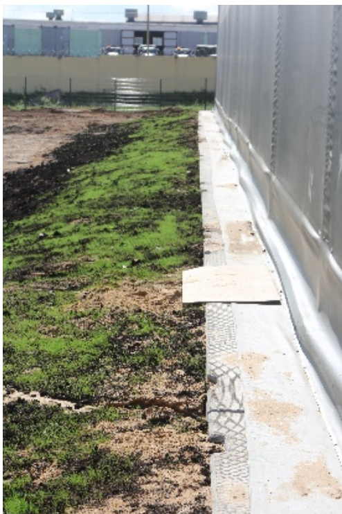
Размывание откосов площадки
