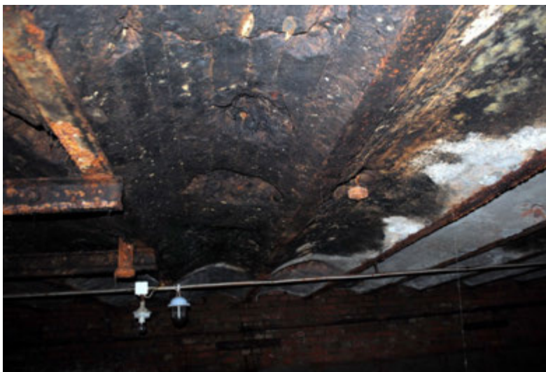
Рисунок 3 – Промасливание бетона сводиков балочного перекрытия
