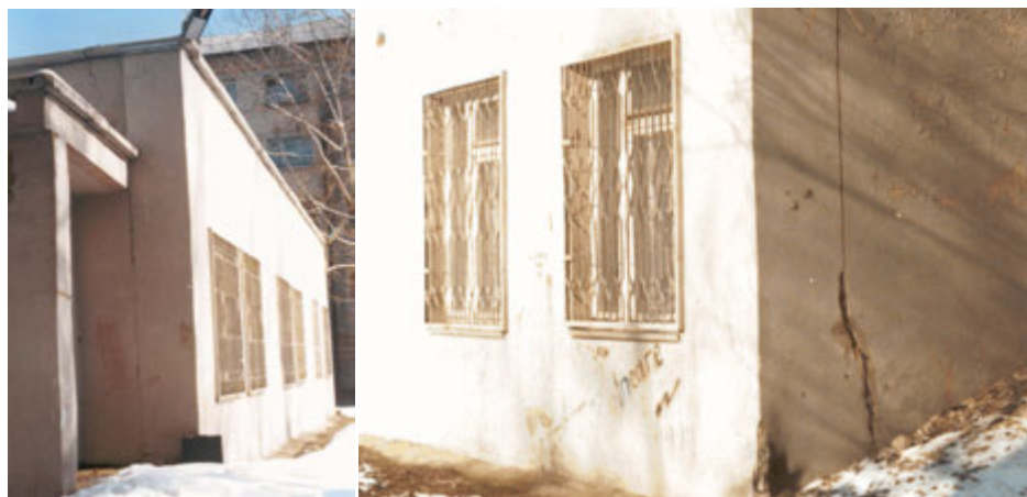
Рисунок 3 – Деформация одноэтажного здания по ул. Стасова 18
