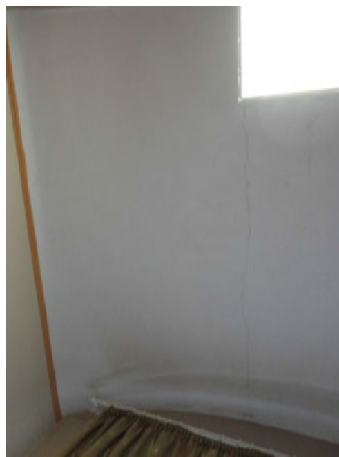
Рисунок 3 – Трещины отделочного слоя распорной конструкции в торцевой части коридора
