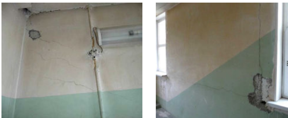
Рисунок 5 – Основные повреждения здания в зоне лестничных клеток (трещины в стенах и швах примыкания элементов)
