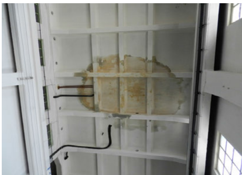
Рисунок 6 – Участок промасленного перекрытия на отм. 30,50 м под помещением масляного бака
