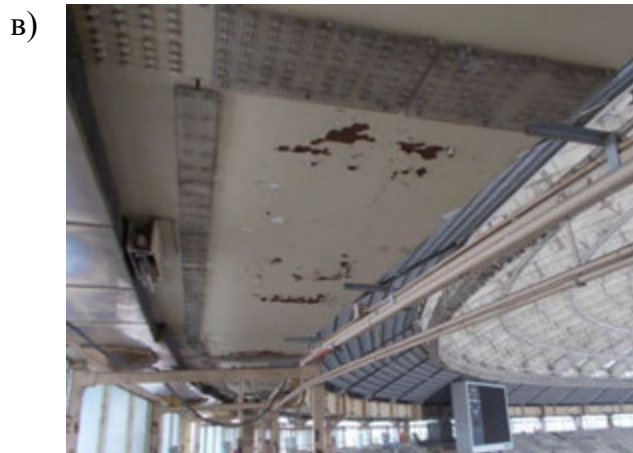
Рисунок 6 – Шелушение краски на верхней полке наружного контура, на болтах и накладке в стыке отсека и разрушение лакокрасочного покрытия до грунтовки на стенке контурного элемента (а). Разрушение лакокрасочного покрытия до грунтовки на стенке наружного контура со стороны поля (б). Шелушение и разрушение лакокрасочного покрытия до грунтовки на нижней поверхности балки (в)
