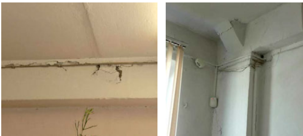
Рисунок 4 – Основные повреждения здания в помещениях (трещины в швах примыкания элементов)
