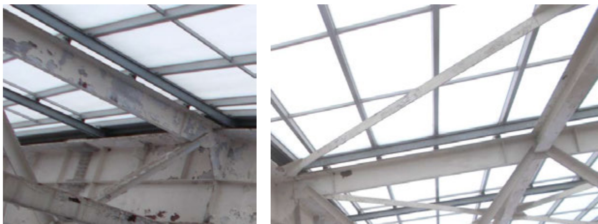
Рисунок 9 – Шелушение краски и разрушение лакокрасочного покрытия до грунтовки на элементах кольцевой фермы и на диагонали горизонтальной связи
