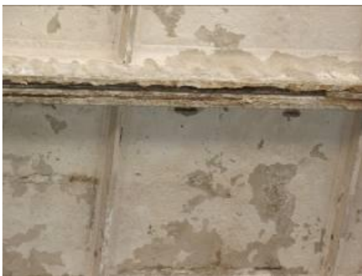
Рисунок 1 - Разрушения защитного слоя бетона с обнажением и коррозией арматуры плиты покрытия действующего промышленного предприятия
