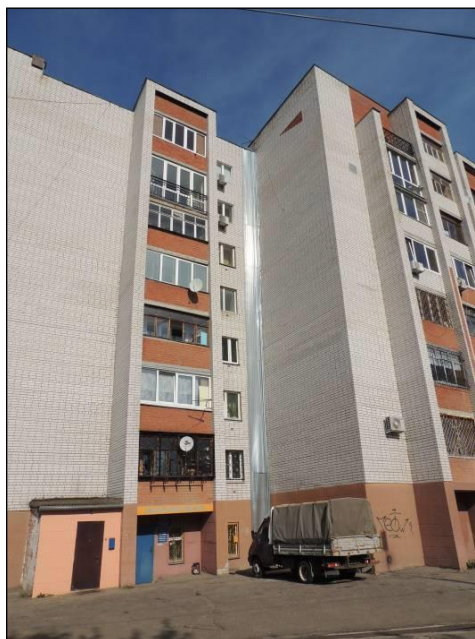
Рисунок 21 – Деформационный шов между секциями №1 и №2
