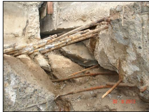
Рисунок 26 – Шурф №4. Разрушение отдельных арматурных стержней
