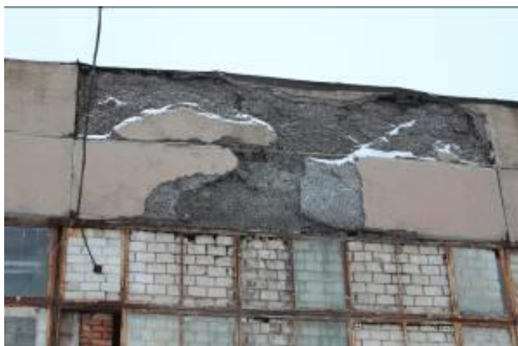
Рисунок 6 - Разрушение стеновой панели неэксплуатируемого здания
