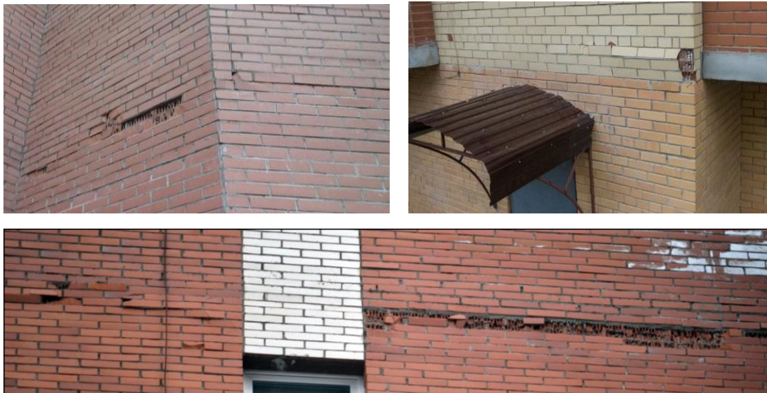
Рисунок 5 - Разрушение каменной кладки облицовочного слоя в уровне расположения междуэтажных плит перекрытий
