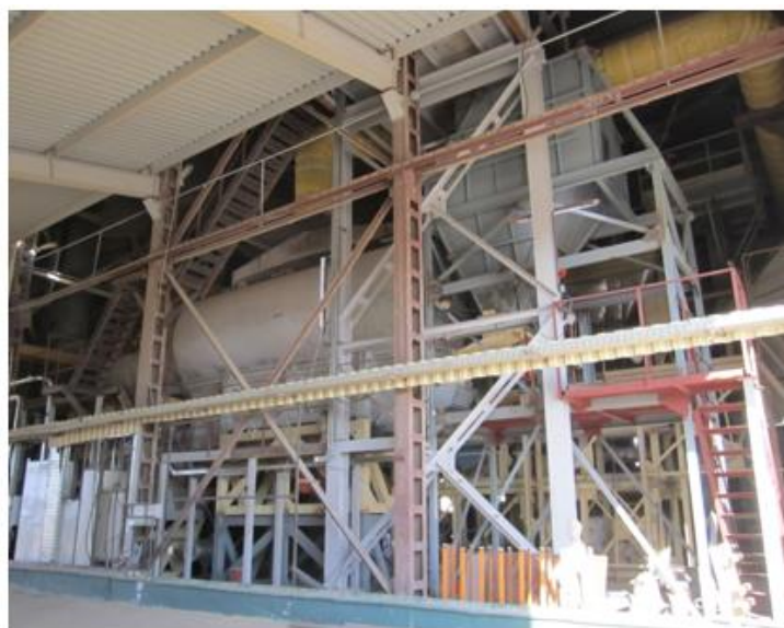
Рисунок 2 – Общий вид стены на участке повышенной вибрации технологического оборудования
