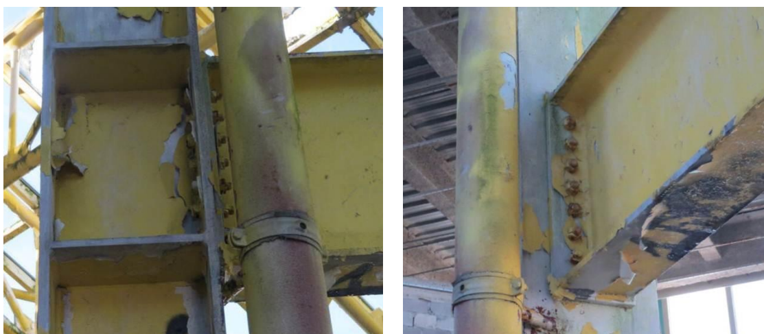
Рисунок 19 – Общий вид узла примыкания нижнего горизонтального ригеля треугольной надстройки атриума. Биологические повреждения, разрушение лакокрасочного покрытия, коррозионные повреждения болтов
