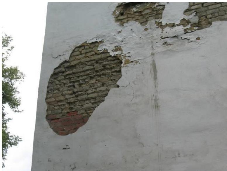
Рисунок 3 - Разрушение наружной версты здания, изменившего функциональное назначение, вследствие монтажа чаши бассейна
