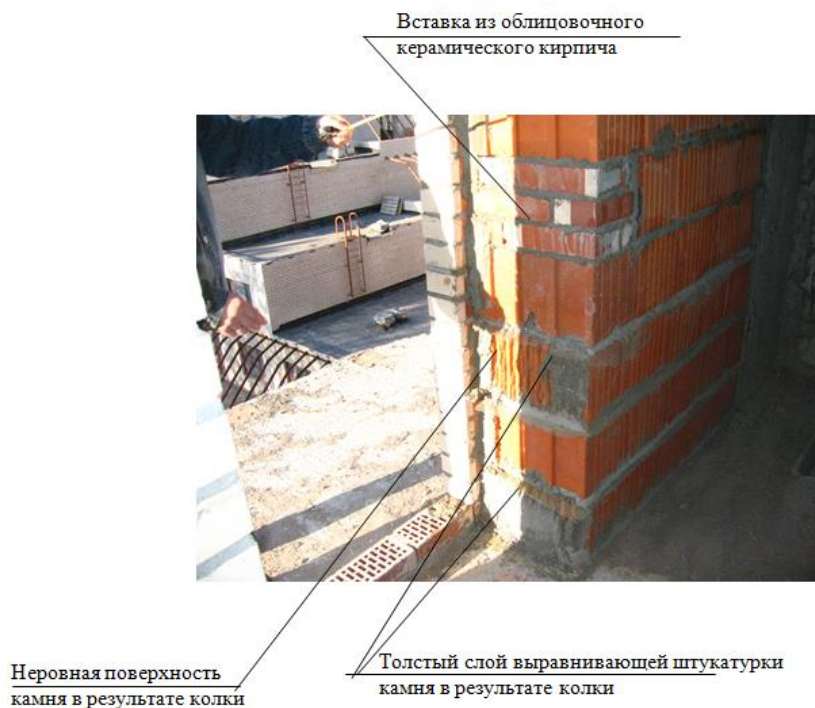
Рисунок 3 – Участок каменной кладки стенового ограждения, ограниченный проемом балконной двери
