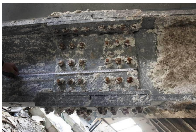
Рисунок 25 – Поверхностная коррозия болтов и гаек в стыках элементов на 19-м этаже
