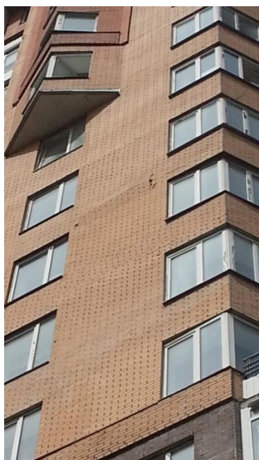
Рисунок 2 - Выпучивание облицовочного слоя
