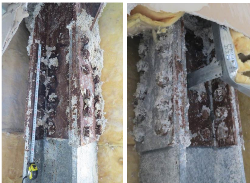
Рисунок 17 – Коррозионные повреждения в монтажном стыке стоек ферм и боковых накладок, разрушение цинкового покрытия на них, коррозионные повреждения болтов, гаек и шайб в уровне 6-го этажа
