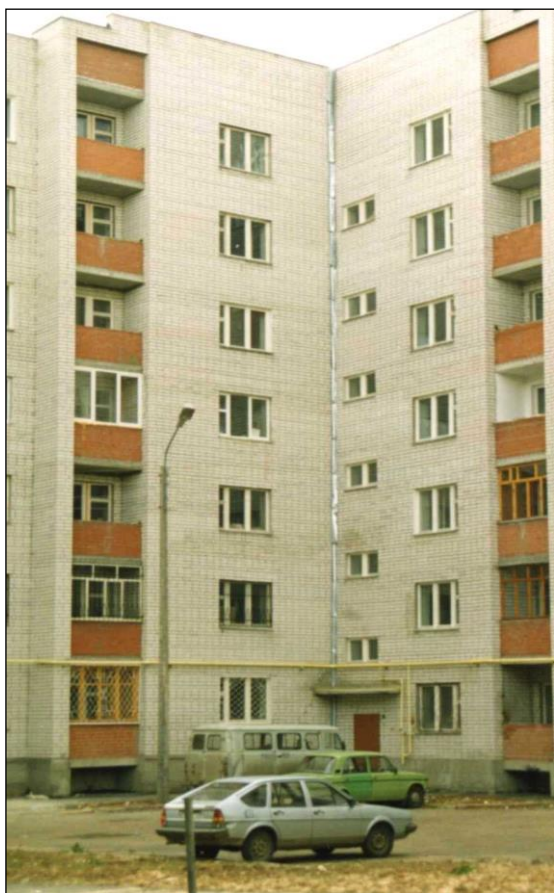
Рисунок 3 – Температурный деформационный шов между секциями №1 и №2 (вид со двора)
