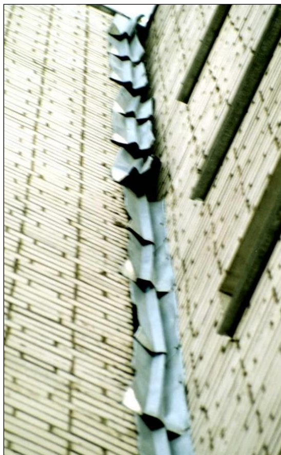
Рисунок 4 - Разрушение нащельника на деформационном температурном шве, отделяющем секцию №1 от секции №2
