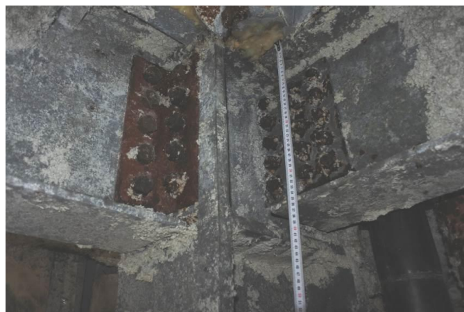
Рисунок 24 – Поверхностная коррозия болтов, гаек и соединительных элементов (уголков, накладок) в узлах опирания балок на колонну на 15-м этаже
