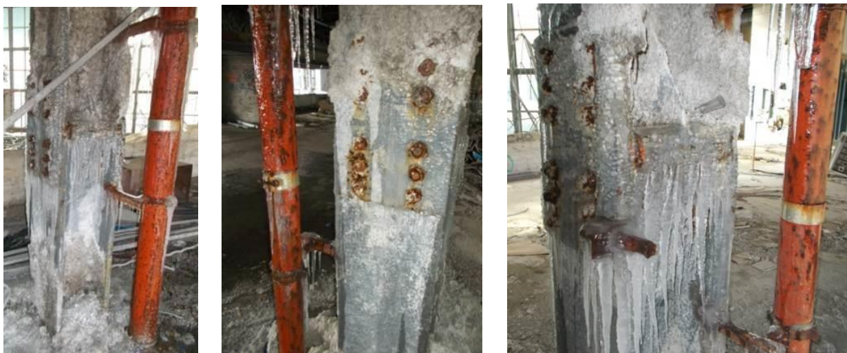
Рисунок 14 – Местная коррозия на полках сечения, у торцов накладки фланцев и коррозия болтов от протечек в стыках колонн на 2-м этаже
