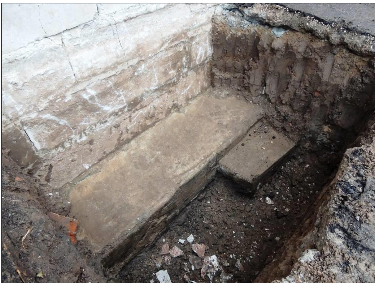
Рисунок 16 - Шурф №6. Вскрытый фрагмент фундаментной плиты с обетонированным оголовком металлической сваи – одного из элементов локального усиления основания, выполненного в 1997-2000 годах
