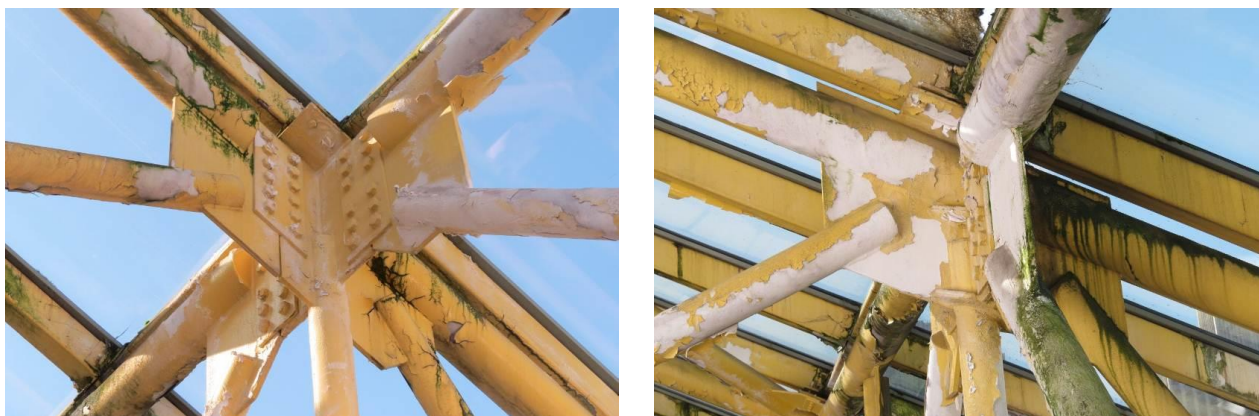
Рисунок 18 – Общий вид типового узла соединения ферм атриума. Биологические повреждения, разрушение лакокрасочного покрытия
