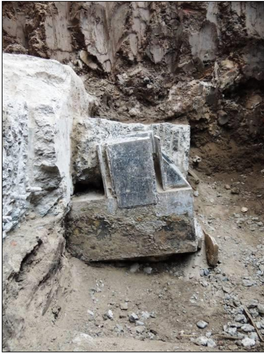
Рисунок 17 - Шурф №6. Деформация конструкции металлической сваи
