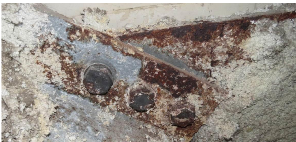
Рисунок 20 – Коррозионные повреждения элемента решетки и боковых накладок конструкций атриума. Разрушение цинкового покрытия, коррозионные повреждения болтов, гаек и шайб
