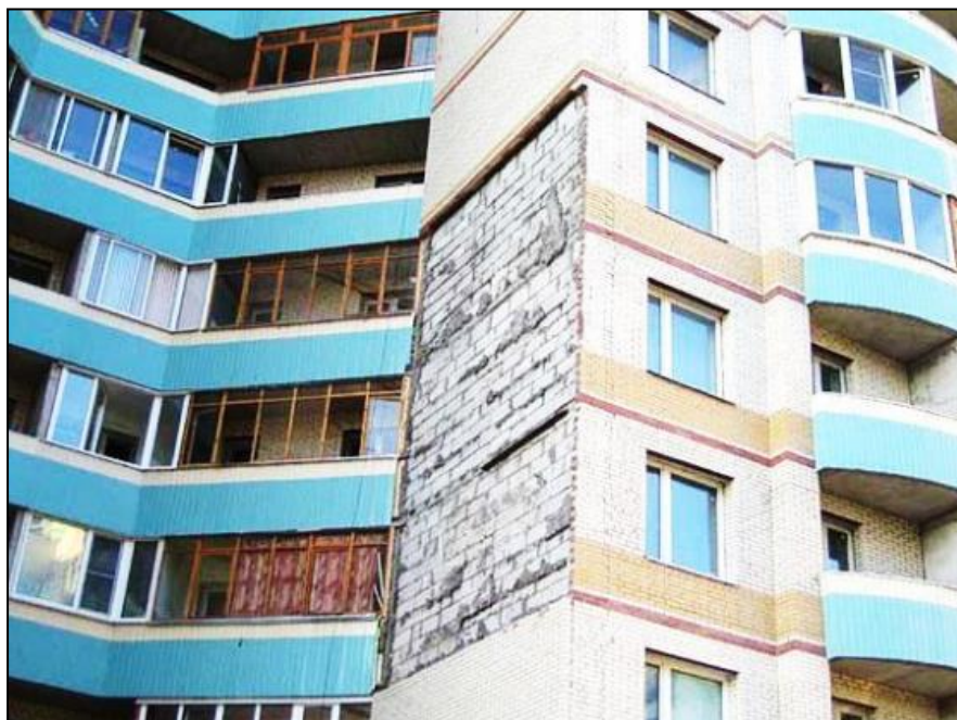
Рисунок 3 - Обрушение облицовочного слоя [38]
