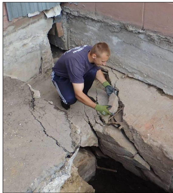
Рисунок 24 – Шурф №4. Расчистка разлома фундаментной плиты
