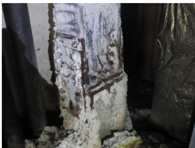
Рисунок 16 – Поверхностная коррозия болтов и гаек. Местная коррозия торцов накладок в стыке колонн на 5-м этаже
