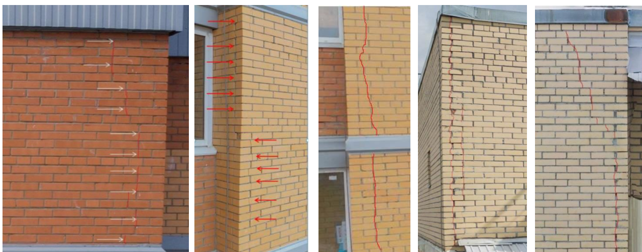
Рисунок 10 - Вертикальные трещины на угловых участках стен
