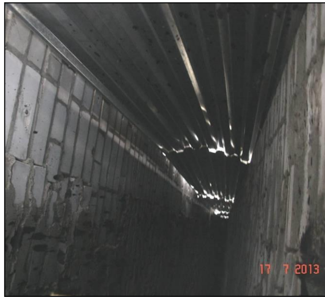
Рисунок 15 - Раскрытие деформационного шва между секциями №1 и №2. Величина раскрытия 750-770 мм. Вид с крыши дома
