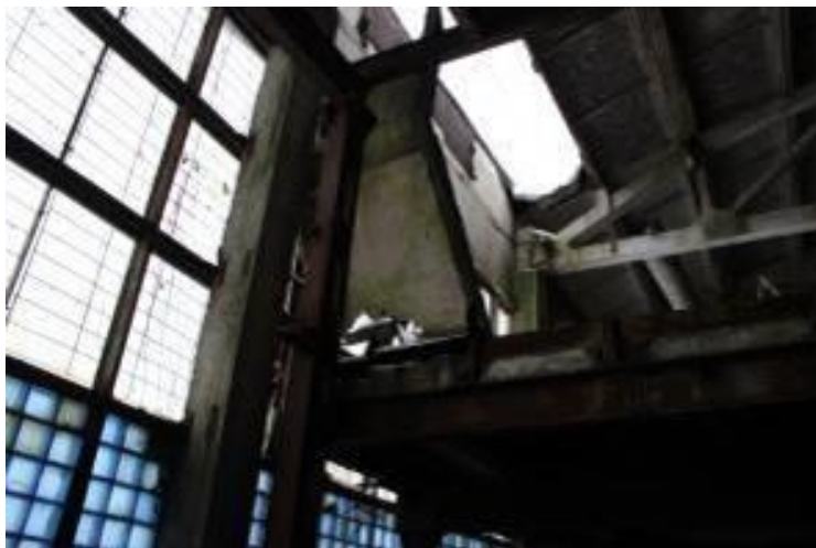
Рисунок 5 - Обрушения плиты покрытия неэксплуатируемого здания
