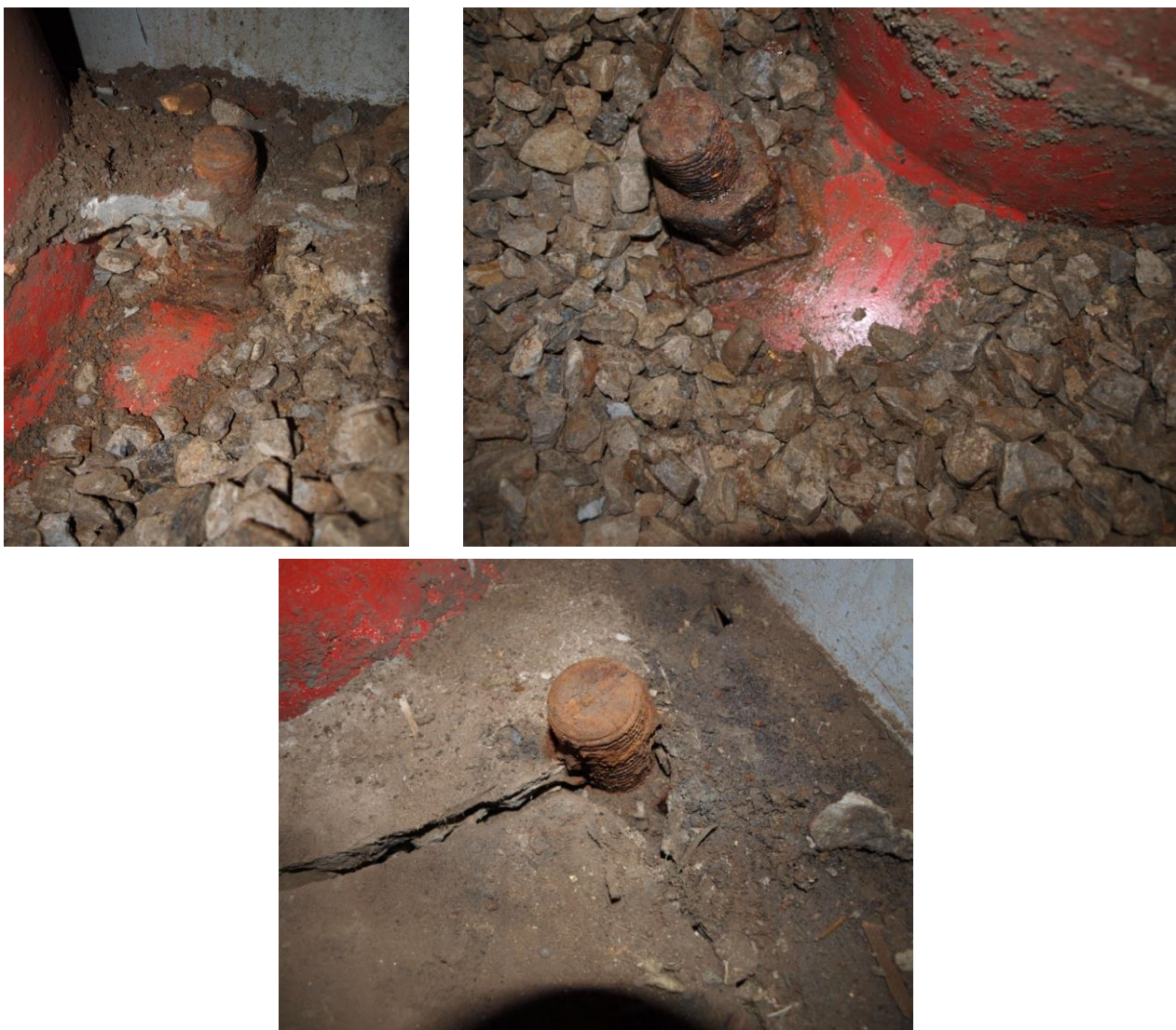
Рисунок 29 – Поверхностная коррозия болтов и гаек в узлах опорных узлов копров
