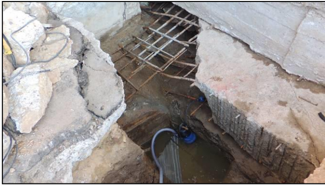
Рисунок 25 – Шурф №4. Коррозия и разрушение арматурных сеток
