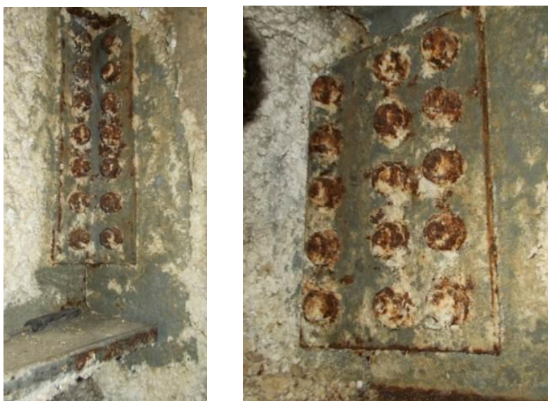
Рисунок 15 – Коррозия болтов на полках соединительного уголка или на соединительной планке (флажке) главной балки в узле примыкания к ней втростепенной балки на 2-м этаже
