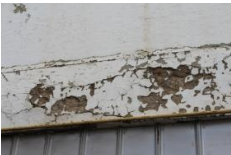
Рисунок 4 - Разрушение стеновой панели здания, изменившего функциональное назначение, при установке дополнительных калориферов
