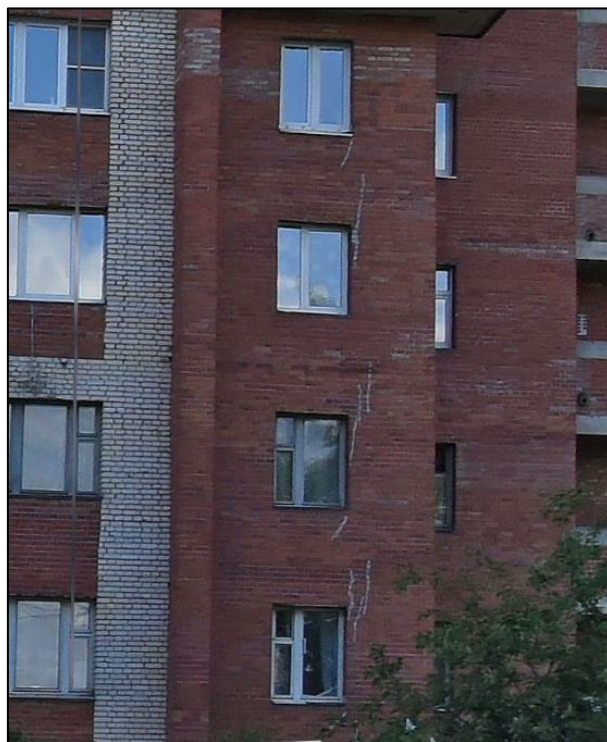
Рисунок 6 – Трещины по межоконным поясам
