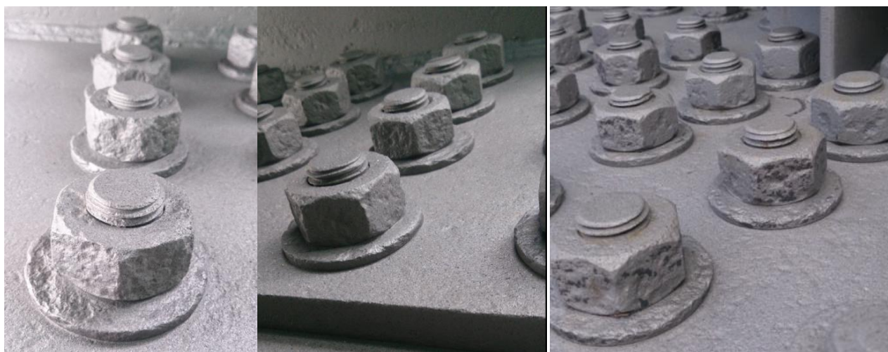
Рисунок 6 – Интенсивная язвенная коррозия гаек и шайб на верхнем поясе внутреннего контура на осях 501, 601
