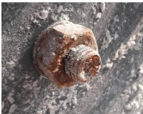
Рисунок 12 – Типичная поверхностная коррозия болтов в стыке колонн на 2-м этаже
