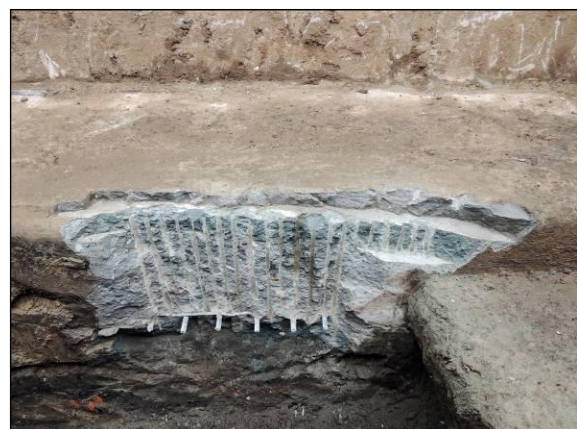
Рисунок 20 – Шурф №6. Многослойная конструкция фундаментной плиты – результат её бетонирования в несколько приёмов со значительными перерывами во времени
