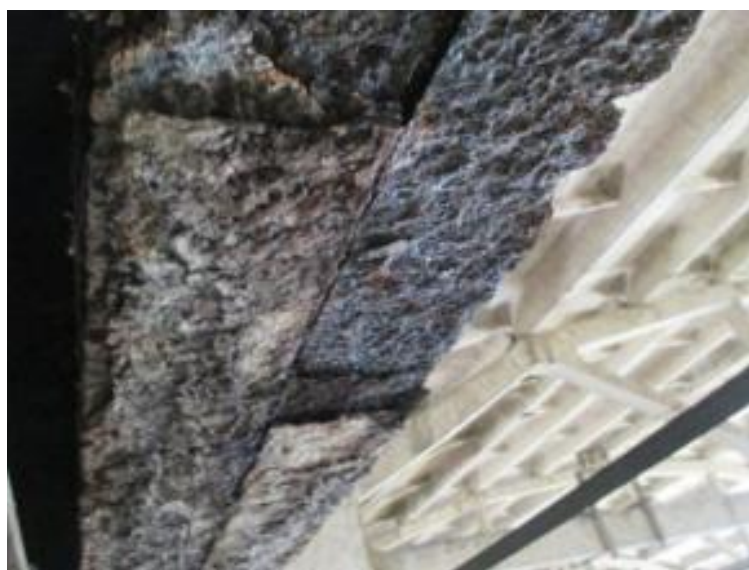
Рисунок 2 - Коррозия металлической балки покрытия действующего промышленного предприятия
