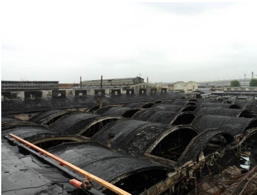
Рисунок 2 – Общий вид цеха №225 с последствиями пожара
