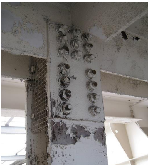
Рисунок 5 – Оси 701-801. Разрушение лакокрасочного покрытия до грунтовки на стойке между средним и верхним поясом внутреннего контура, а также на болтах в узле соединения
