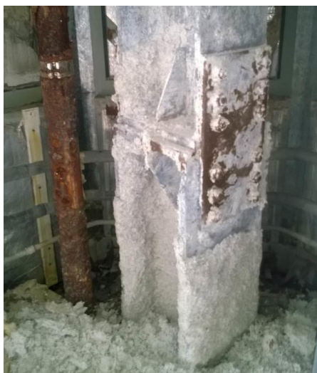
Рисунок 21 – Поверхностная коррозия болтов, гаек. Местная и сплошная коррозия соединительных элементов (накладок и фланцев) в стыке колонн на 8-м этаже
