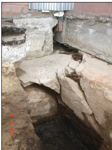
Рисунок 23 – Шурф №4. Разрушение фундаментной плиты
