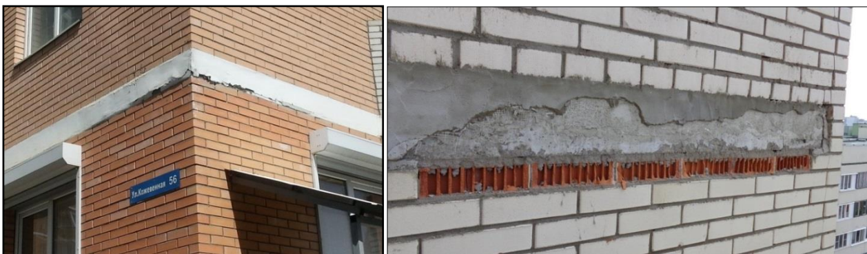
Рисунок 6 - Отслоение декоративной облицовки
