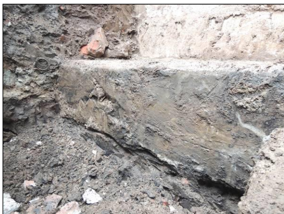
Рисунок 19 – Шурф №6. Фундаментная плита опирается на насыпной грунт содержащего большое количество органических включений и строительного мусора
