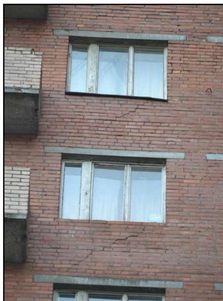
Рисунок 4 – Наклонные трещины по межоконным поясам
