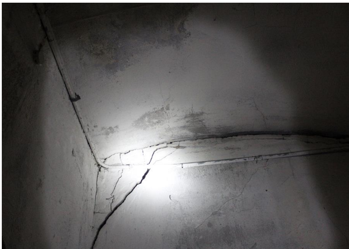
Рисунок 5 – Трещина по плите перекрытия, переходящая в наклонную трещину по стене шириной раскрытия 0,3 мм
