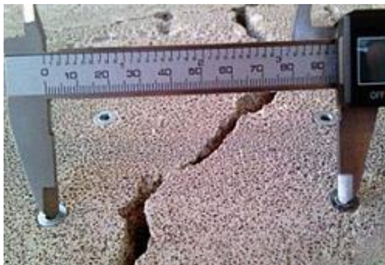
Рисунок 4 – Измерение ширины раскрытия трещины штангенциркулем
