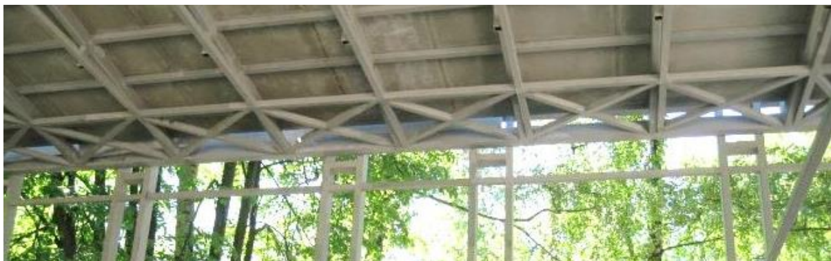
Рисунок 11 – Опираение стропильных ферм на подстропильную балку по ряду В павильона (видны крестовые продольные горизонтальные связи)
