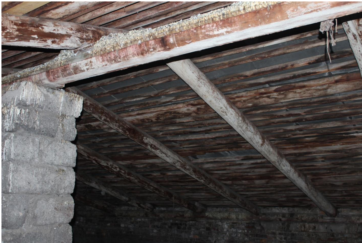
Рисунок 8 – Следы намокания кирпичной кладки и мауэрлата, гниение стропильных ног и обрешетки
