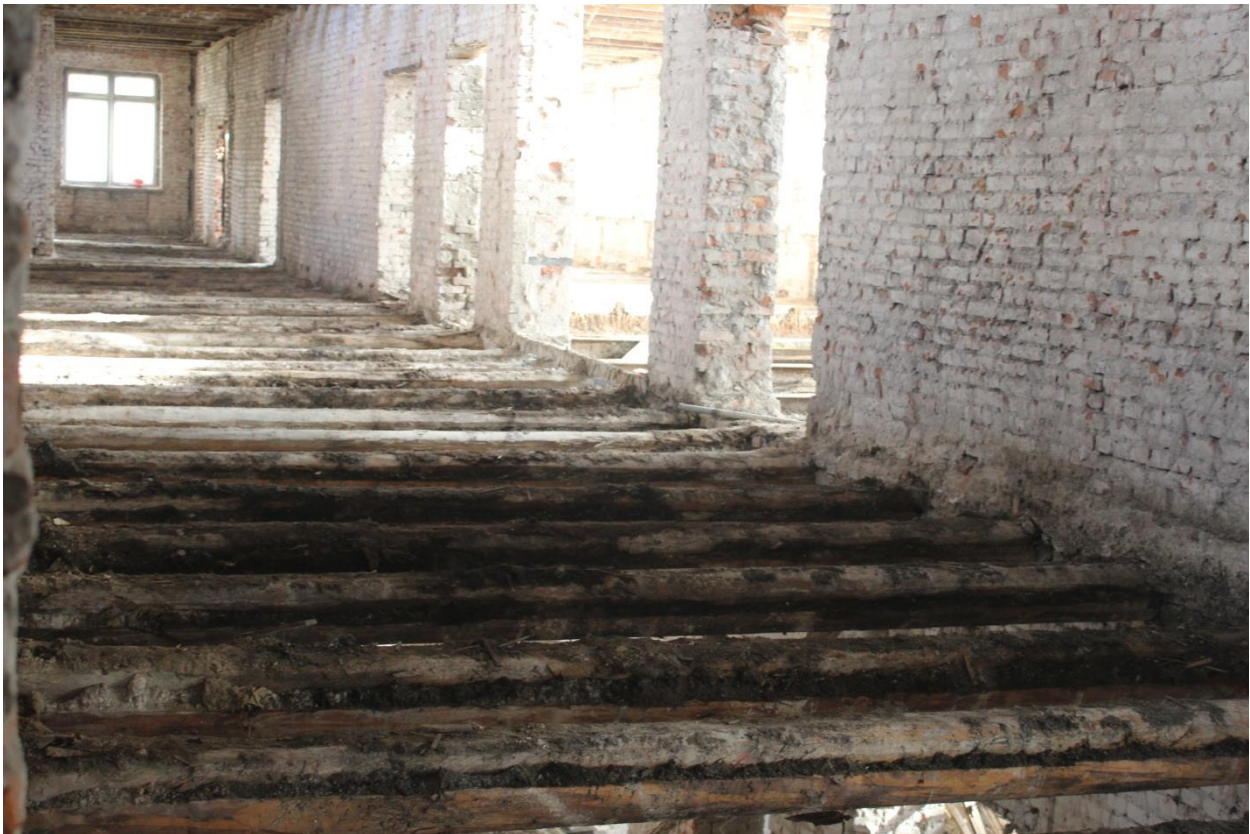
Рисунок 7 – Следы замачивания и следы биологического поражения на балках перекрытия
