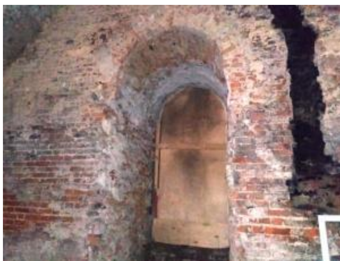
Рисунок 4 - Каземат неэксплуатируемой части куртины. Потемнения на кладке и отделке. Высолы. Поражение фанерного заполнения проема. В теле «штрыбы» имеются поражения плесневыми грибами
