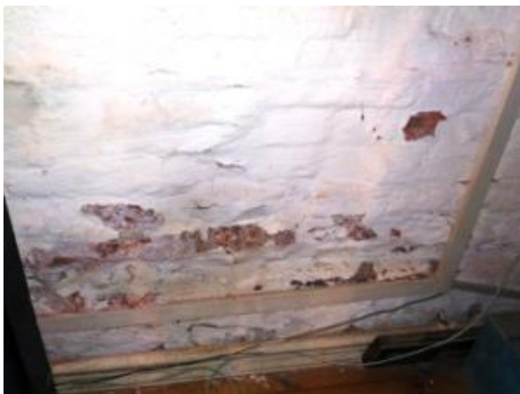
Рисунок 2 - Высолы и небольшие колонии плесневых грибов на стенах одного из казематов эксплуатируемой части куртины
