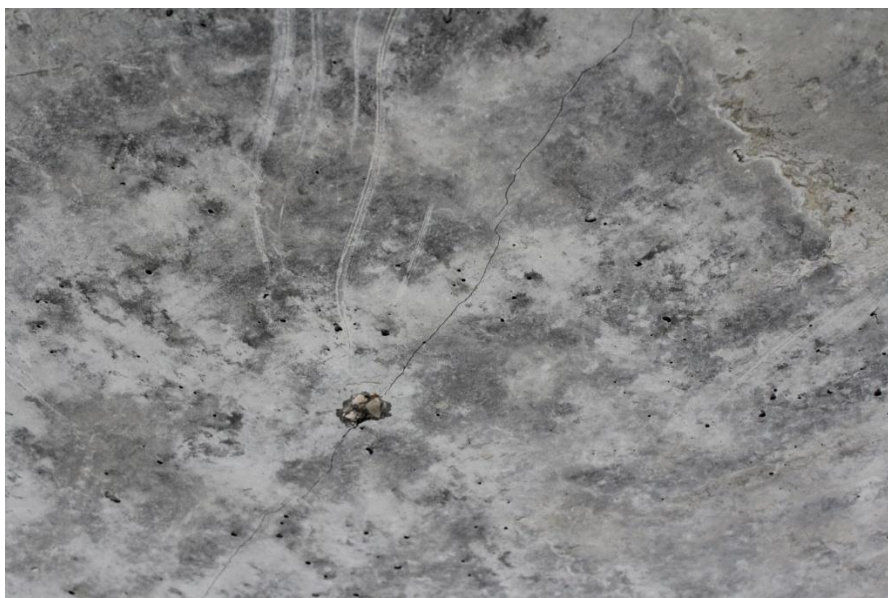
Рисунок 1 - Диагональная трещина в панели перекрытия
