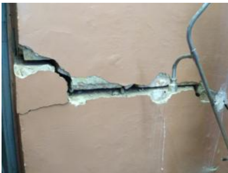
Рисунок 3 - Трубецкой бастион. Сквозная деформационная трещина перегородки
