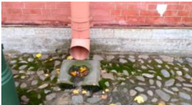
Рисунок 7 - Внутренняя часть куртины. Поражение био пленкой цоколя, мох и водоросли на отмостке
