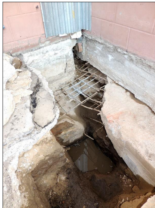
Рисунок 6 - Разрушение арматурных сеток в разломе фундаментной плиты (см. рис. 4)
