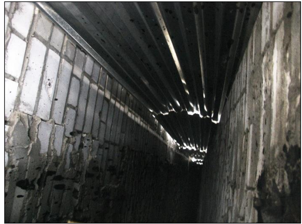
Рисунок 4 - Раскрытие деформационного шва между секциями №1 (стена справа) и №2 (стена слева). Вид с крыши дома
