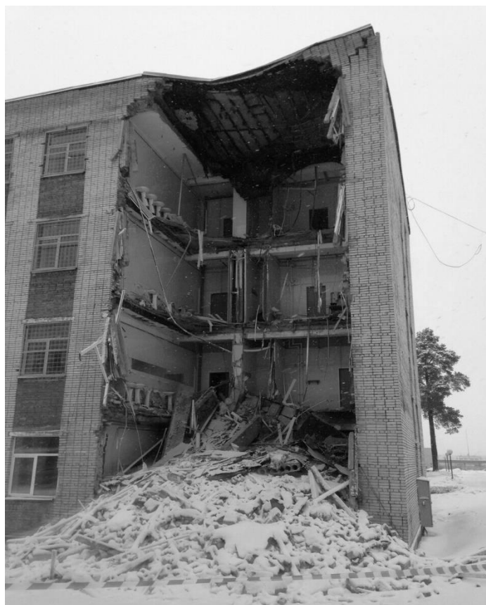
Рисунок 1 – Казарменное здание войсковой части Западного военного округа после обрушения одного пролета
