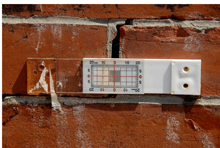
Рисунок 2 – Пластинчатый маяк на трещине
