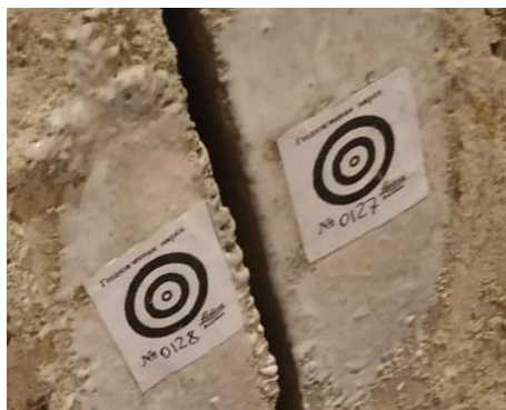
Рисунок 6 – Пара марок, закрепленных на трещине
