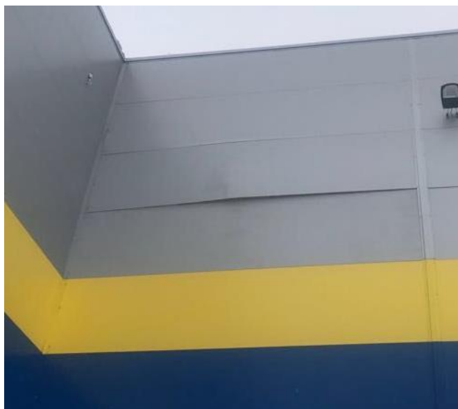
Рисунок 20 – Состояние конструкций покрытия после потери устойчивости фасонки нижних поясов ферм
