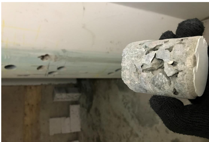
Рисунок 5 – Следы непровибрированного бетона в отобранном образце-kerne из монолитной железобетонной колонны
