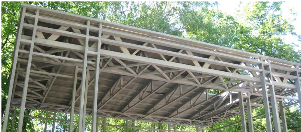
Рисунок 16 – Крепление подстропильных ферм покрытия павильона № 5 на стойки по рядам А и Б
