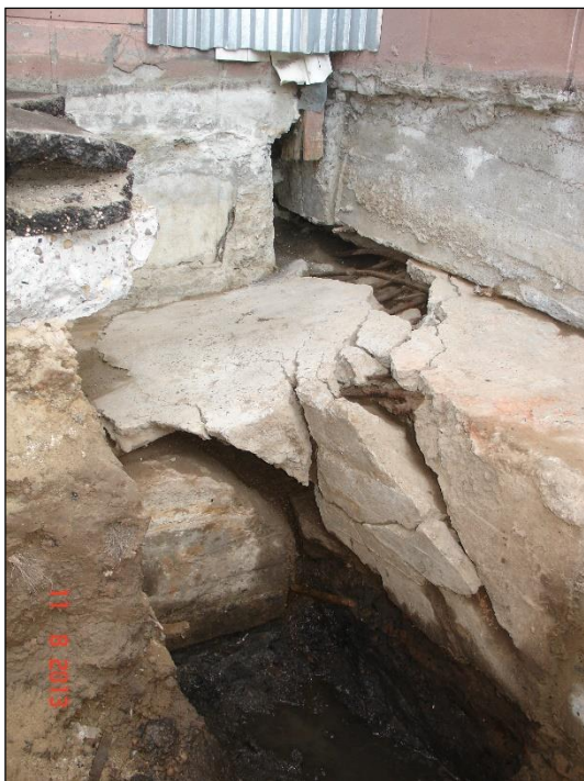
Рисунок 5 - Разлом в фундаментной плите под деформационным швом между секциями №2 и №1
