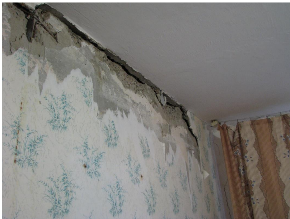
Рисунок1 - Вид повреждений и деформаций платформенного стыка панели перекрытия и стеновой панели
