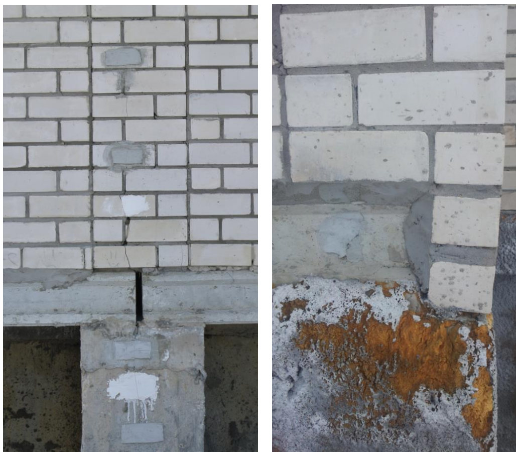
Рисунок 2- Кирпичные пилоны, качество выполнения, дефекты и повреждения
