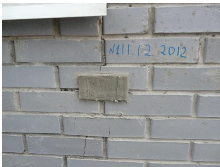
Рисунок 1 – Маяк цементный на трещине
