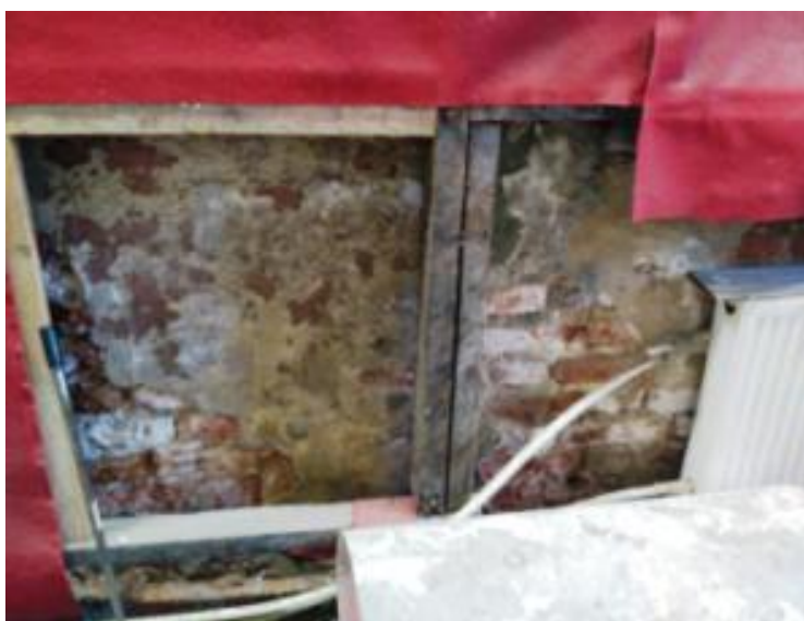
Рисунок 1 - Поражение плесневыми грибами, высолы на нижней неотделанной части стены под окном в одном из казематов эксплуатируемой части куртины
