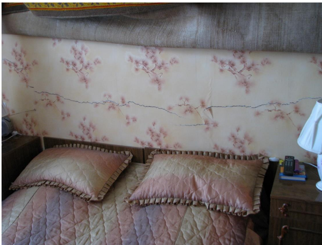
Рисунок 2 - Вид внутренней поперечной стены, получившей искривление из плоскости с образованием трещин «разрыва»
